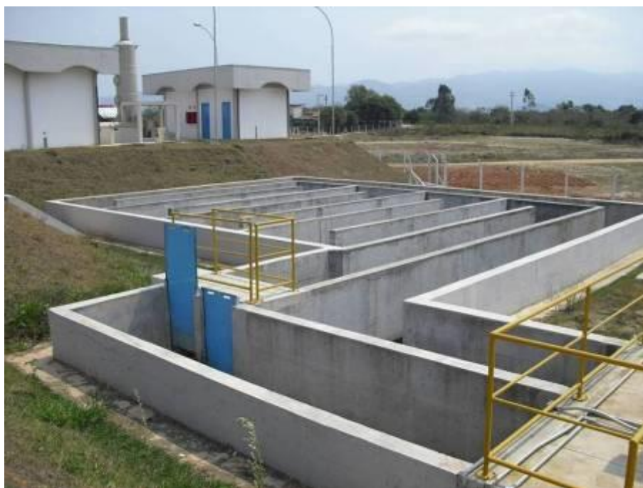
Foto 22 – Tanque de Contato – Desinfecção Final do Efluente
