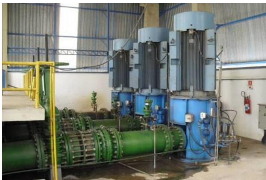
Foto 06 – Estação Elevatória de Água Bruta – Vista Interna da Casa de Bombas
