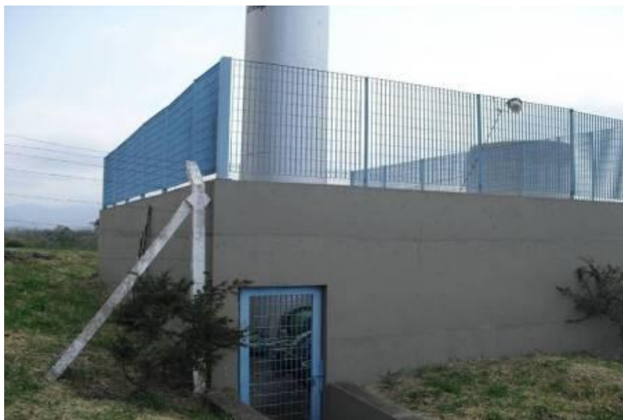
Foto 08 – Tanque de Amortecimento Unidirecional 01 Taubaté - Adutora de Água Bruta Rio Paraíba do Sul
