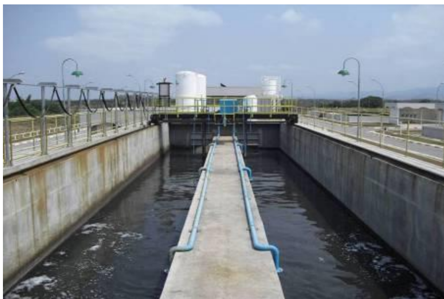
Foto 16 – Caixa de Areia Mecanizada
