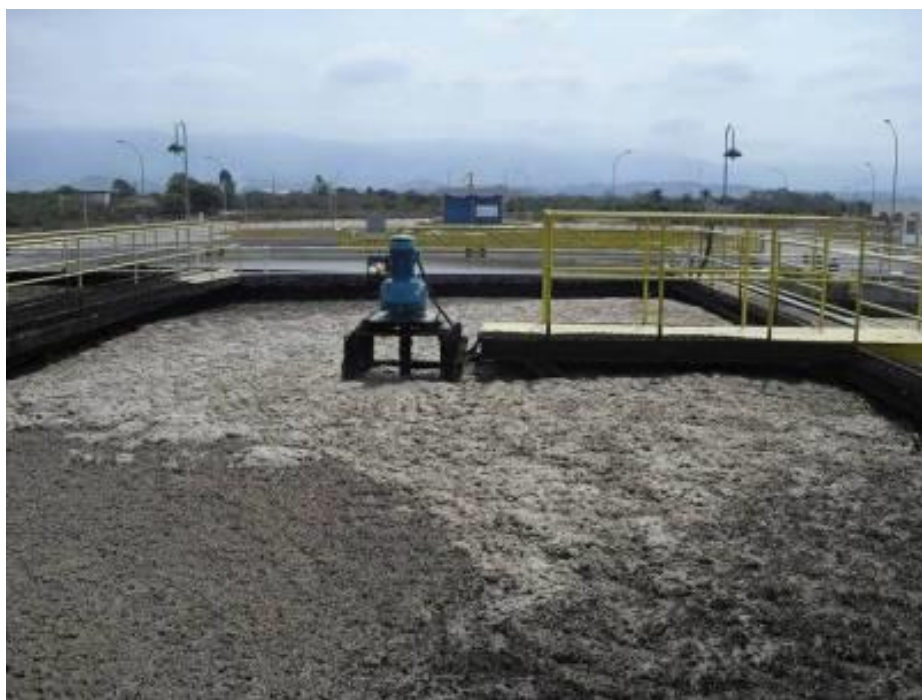
Foto 18 – Tanque de Aeração
