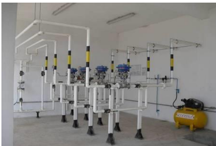
Foto 17 – Sistema de Injeção de Oxigênio Puro nos Tanques de Aeração
