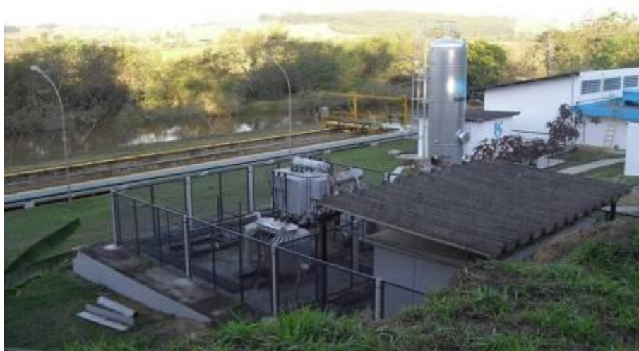
Foto 04 – Captação de Água no Rio Una
