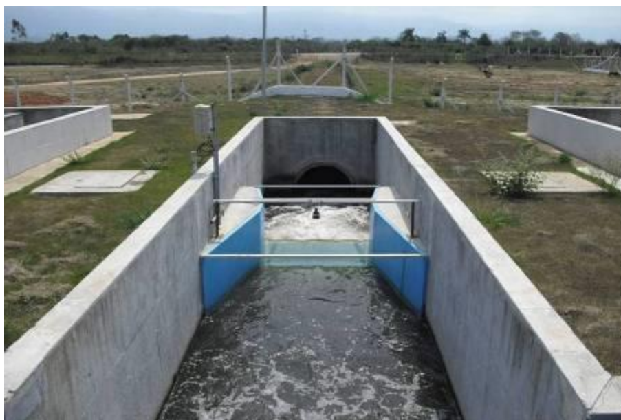
Foto 23 – Medição Final de Vazão e Emissário de Esgoto Tratado
