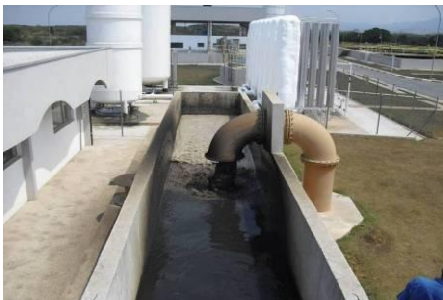
Foto 21 – Retorno de Lodo para a Entrada dos Tanques de Aeração
