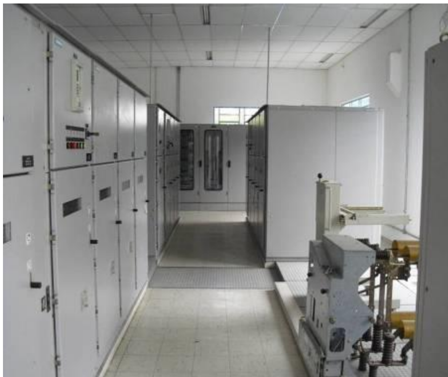
Foto 07 – Painéis de Controle – Estação Elevatória de Água Bruta do Rio Paraíba do Sul
