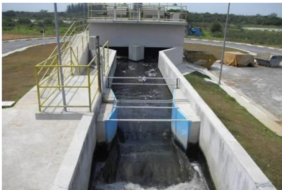
Foto 14 – Medição de Vazão Afluente – Calha Parshall
