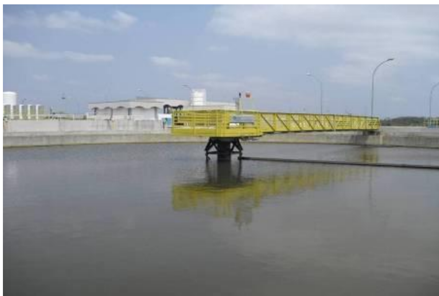
Foto 19 – Decantador com Remoção Mecânica
