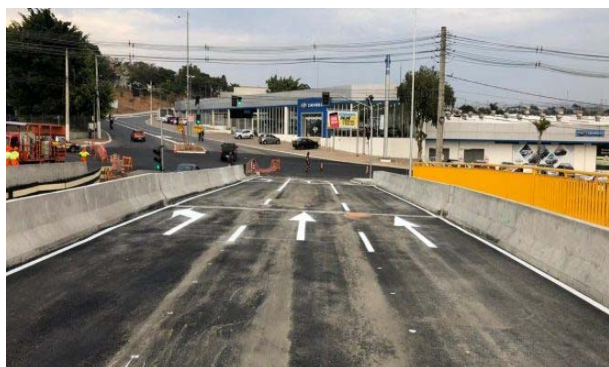
Figura 76. Viaduto Boa Vista – recentemente duplicado, possui 3 faixas de rolamento em cada sentido e passagem exclusiva de pedestre.
