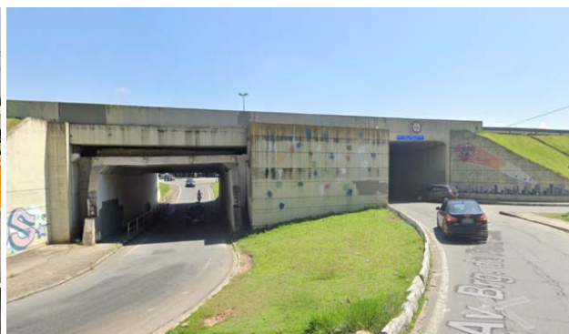
Figura 77. Túnel Emílio Amadei Beringhs – possui 2 faixas de rolamento em cada sentido e passagem exclusiva de pedestre
